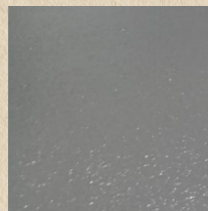
Cuarto de Máquinas Pintura epóxica en pisos color gris perla
